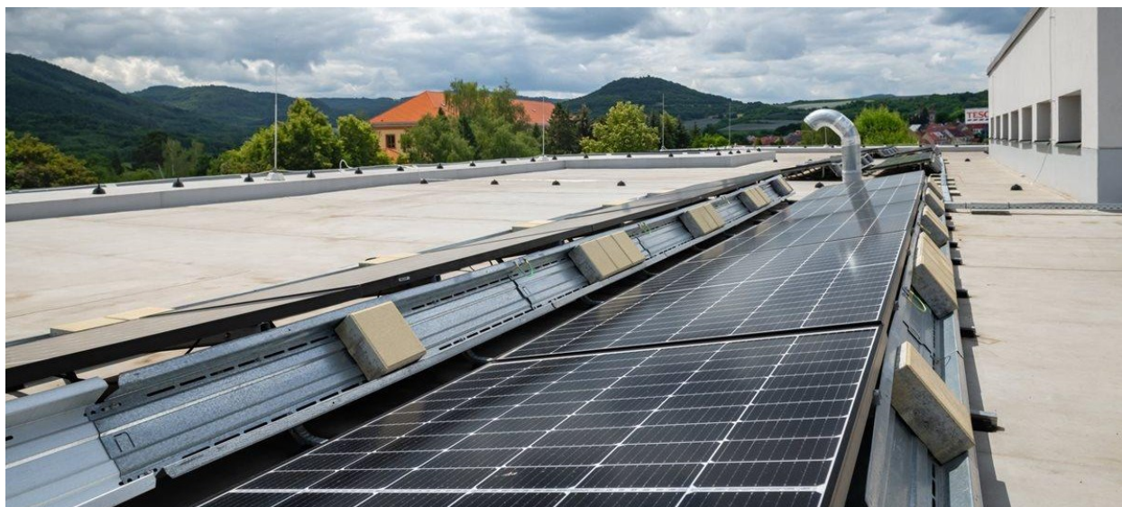
Obr. 53: Střešní fotovoltaická elektrárna
